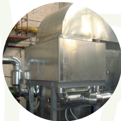
КП «Вишнівськтеплоенерго» утилізатор за котлом ПТВМ-30м
