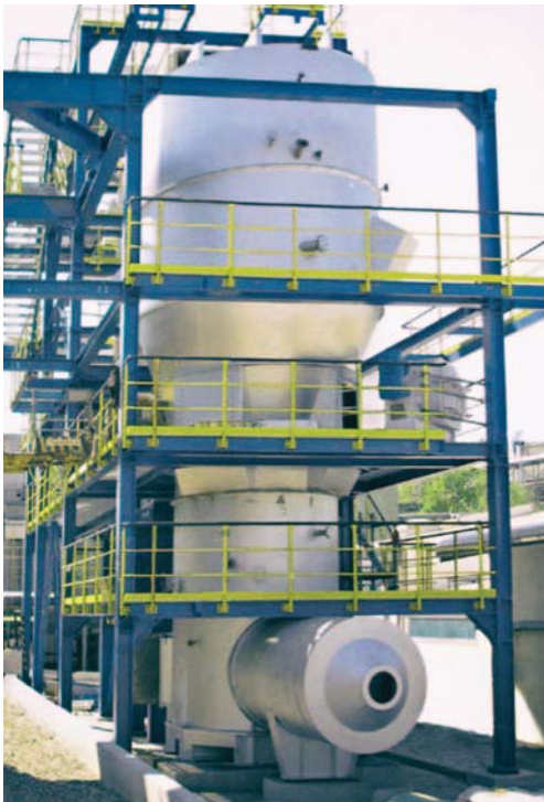
Рис. 2.29 Зовнішній вигляд термічного реактору із закритою системою подачі повітря
