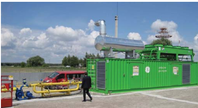
Рис. 5.28 Двигун внутрішнього згоряння з електрогенератором потужністю 1 МВт компанії GE Jenbacher на полігоні м. Бориспіль, Україна
