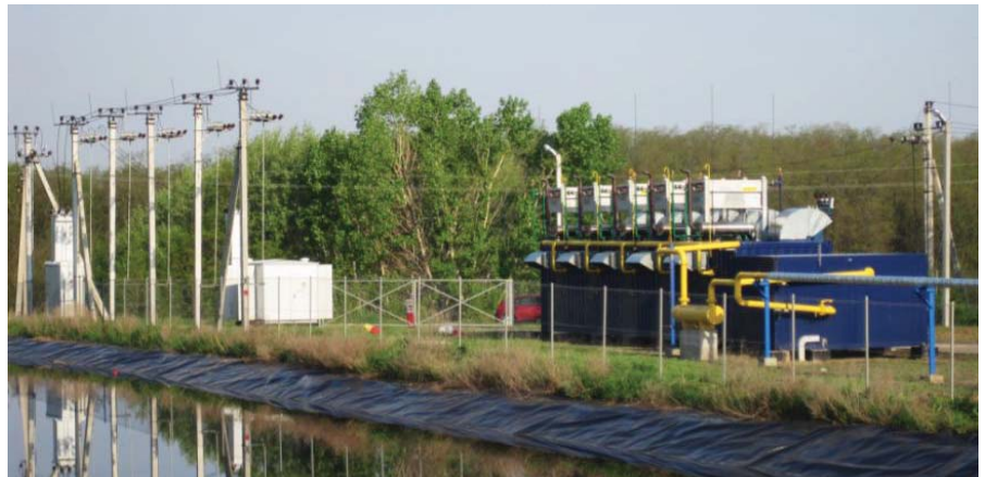
Рис. 5.33 Станція утилізації ЗГ для виробництва електроенергії (полігон №5, м. Київ, Україна)
