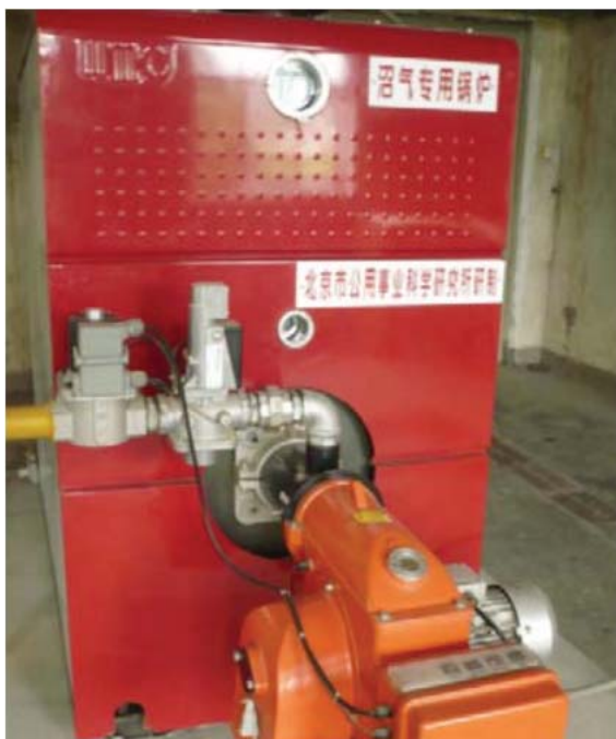
Рис. 5.24 Водогрійний котел на полігоні Gaoantun в Пекіні, Китай
