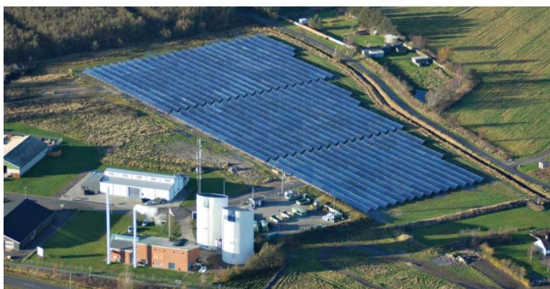
Рис. 1.33 Завод із сонячною системою тепlopостачання в м. Страндбі, Данія з площею сонячних колекторів 8000 м 2
